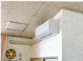
作業室の冷房専用エアコン
